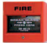
пожарная сигнализация pozhar'naya signalizatsiya fire alarm
